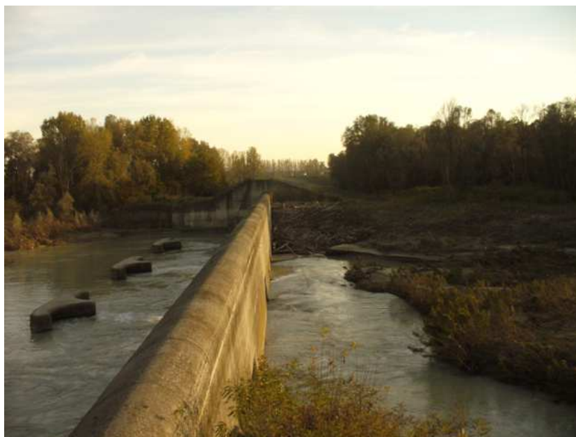
Figura 7 - Manufatto regolatore della Cassa, Dx monte, SX valle. Si noti la presenza di materiale flottante che ostruisce le luci di fondo
