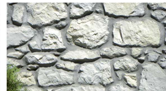
Fig. 47: Impiego improprio di malte cementizie.
