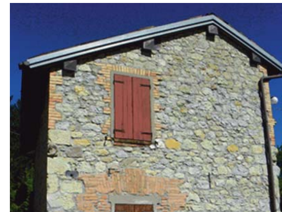
Fig. 45: Impiego improprio di malte cementizie.
