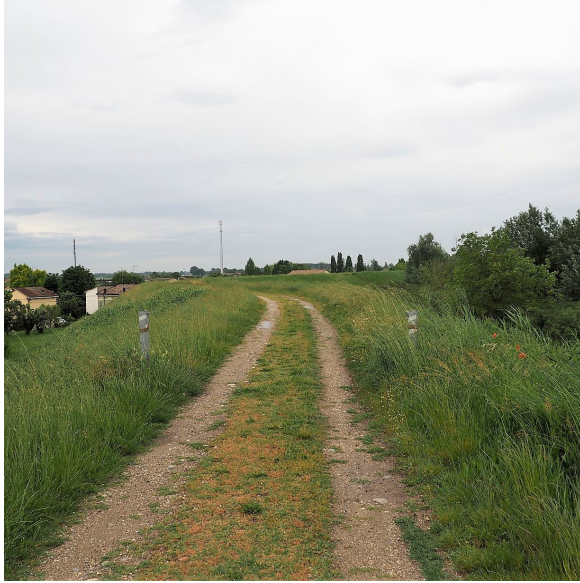
Pista su argine destro
